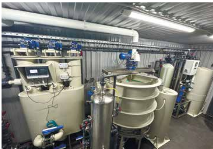
Установка физико-химической очистки в контейнерном исполнении
